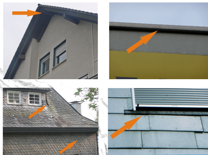
Typische Spaltenquartiere von Zwergfledermäusen an Gebäuden. Die Pfeile deuten auf die Einflugöffnungen.
